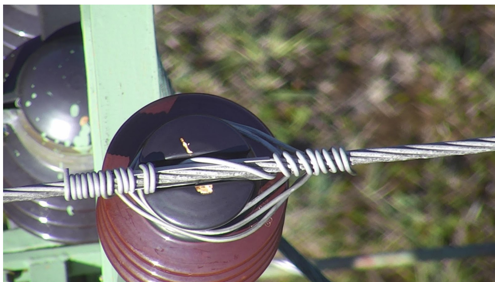
Figur 8 Visar en närbild på en isolator, taget ovanifrån med hjälp av en drönare (Bankert, 2020)
