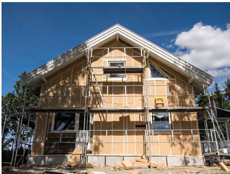
Figur 2.5 Bilden visar ett hus som har träfiber som isolering mellan träreglar (Hunton, 2019b)
