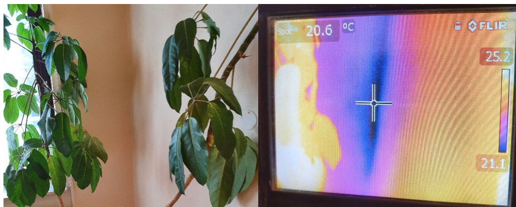
Figur 3.7 Bilderna visar ett hörn från 80-talsbyggnaden. Temperaturskillnaden är ca 4 grader.
