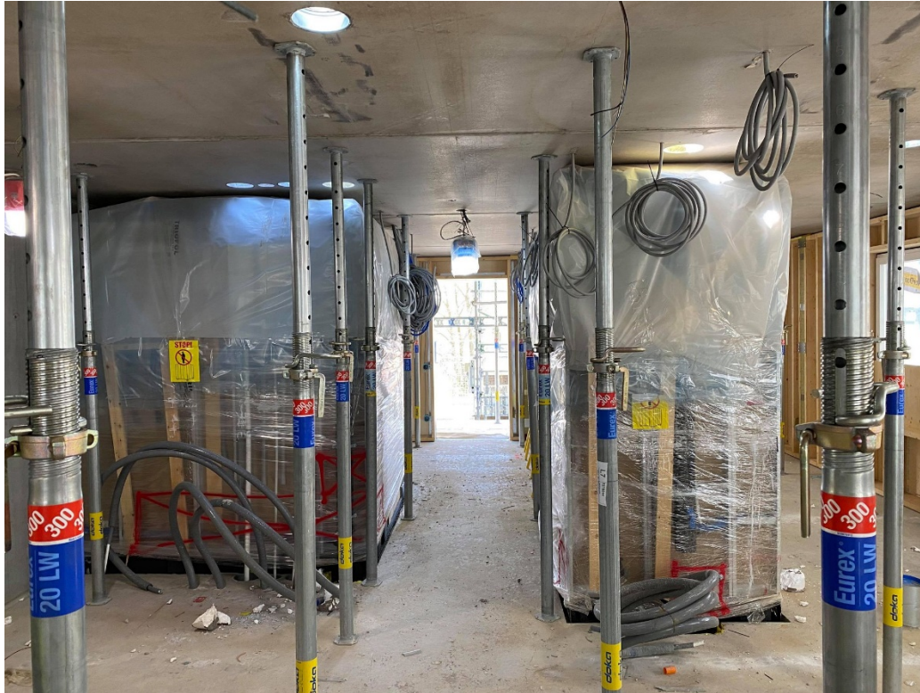
Figur 27 Två badrumsmoduler med emballage på som de ska stå tills huset är helt torrt och inbyggt.
