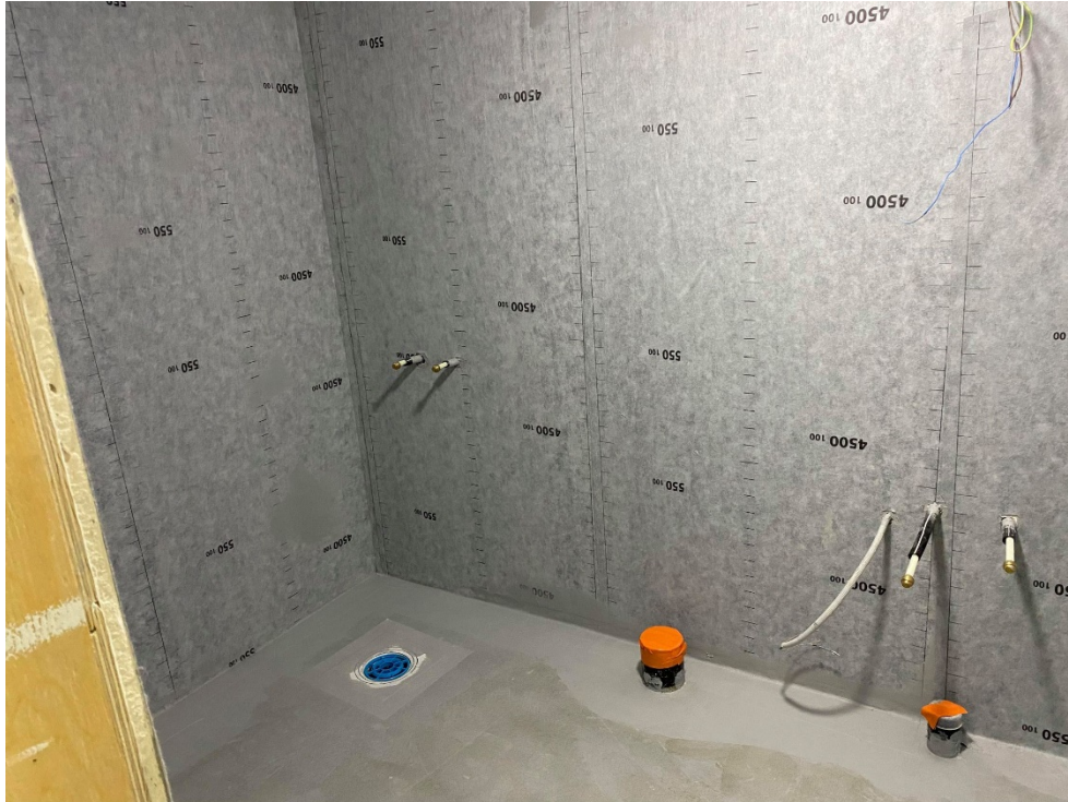
Figur 31 Badrum på Referensprojektet med tätskikt på väggar och ett uppbyggt fall mot golvbrunnen.
