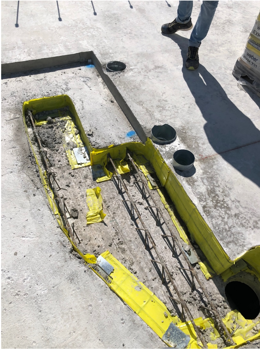
Figur 35 Ursparning med armeringsstegar som måste kapas
