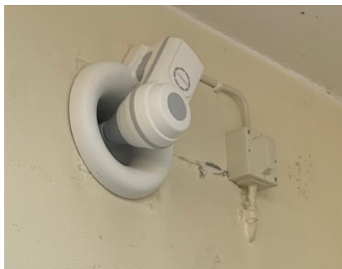
Figur 3.11 F-systemet i arkivet i 80-tals byggnaden. Bild tagen av Diana Kron.
