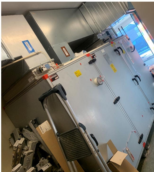
Figur 3.5 visar FTX-aggregatet av modell Envistar Top, installerat av iv produkt, för ventilationen i 60-tals byggnaden. Bild tagen av Diana Kron.
