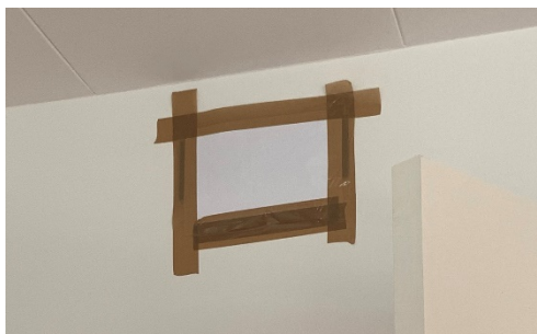
Figur 3.12 Ett blockerat tilluftsdon i ett av kontorsrummen i 80-tals byggnaden. Bild tagen av Diana Kron.
