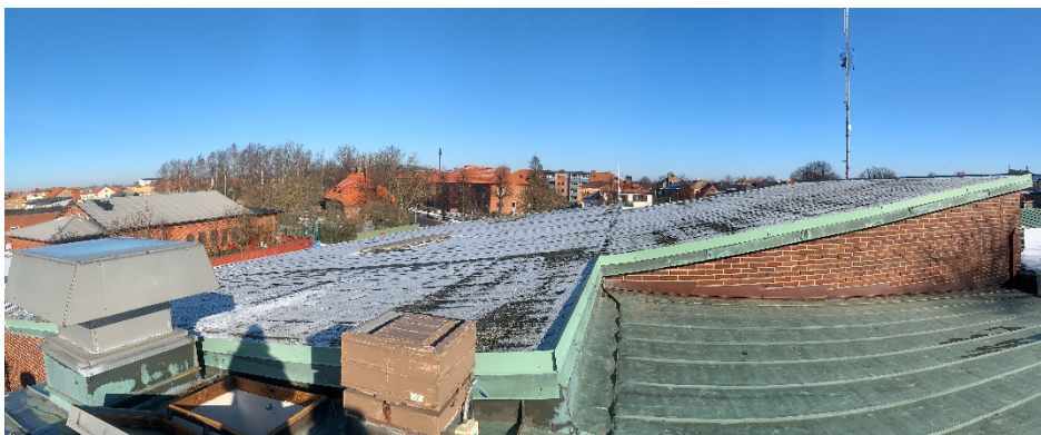
Figur 3.14 Pulpettak av papp på ställverket med en lutning på 10°. Riktning nordväst. Bild tagen av Diana Kron.
