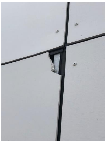
Figur 1. Sprickbildning i hörn av fibercementskiva där en del av skivan lossnat (Jönsson & Remnetorp, 2019).
