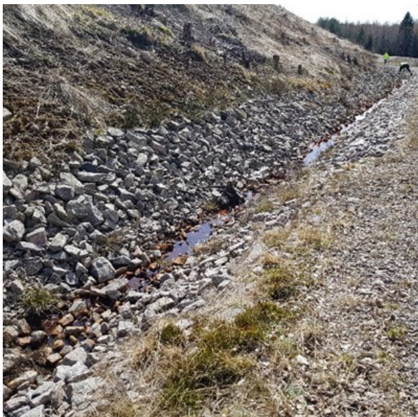
Figur 3 - Ett dräneringsdike vid en kraftdamm i Småland. Man ser rödslam i botten av färan längs med hela dammen. Foto av Simon Eng.
