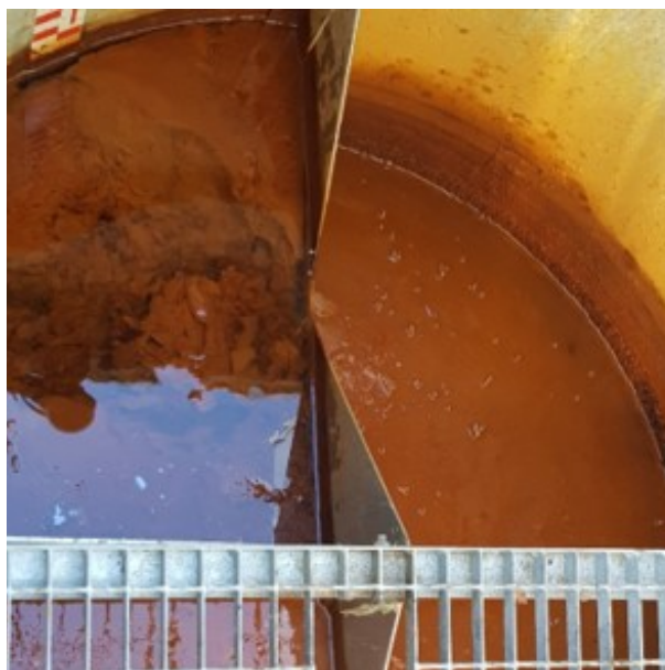
Figur 1 - Ett Thomsonöverfall som är fyllt med en problematisk mängd rödslam. Den stora volymen rödslam ökar det skenbara flödet av vatten, vilket leder till felmätningar. Foto av Simon Eng
