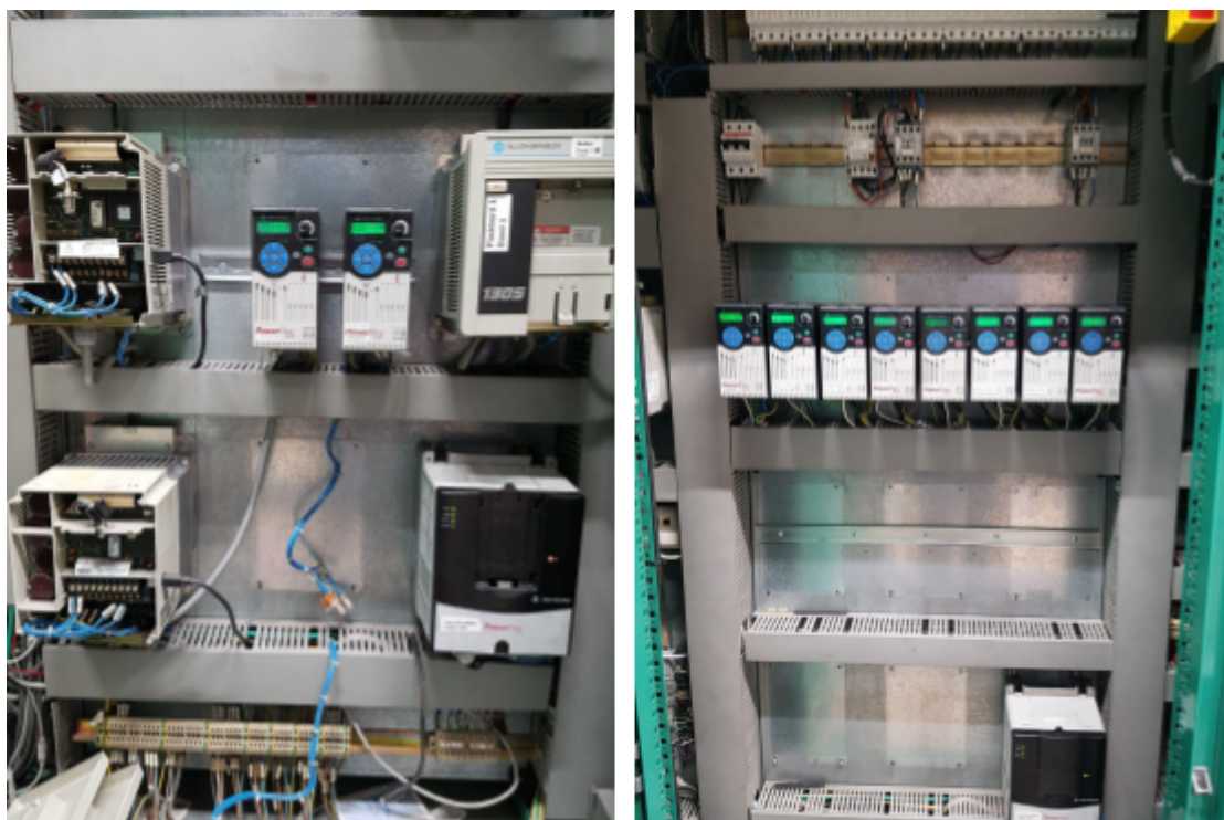
Figur 5.2: Styrskåp innan (höger) och styrskåp efter montering (vänster)
