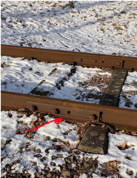
Bild 15. Bilden visar att det saknas befästningar på rälen.
