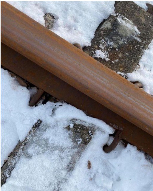
Bild 13. Bilden visar hur de monterade befästningarna har lossnat.
