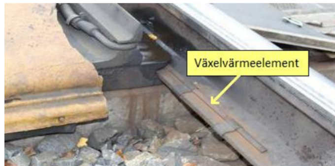
Figur 4.1.2.2.1: Växelvärme element i EV-UIC60-300-1:9 spårväxel / (Trafikverket, 2010)
