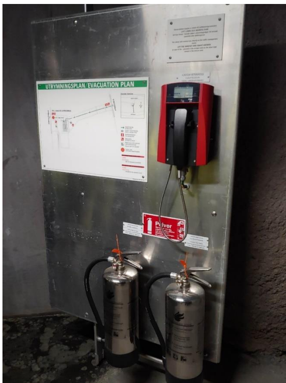
Figur 5 Brandsläckare, nödtelefon och utrymningsplan i sluss i utrymningsväg (Bild av Linnea Mauritz)
