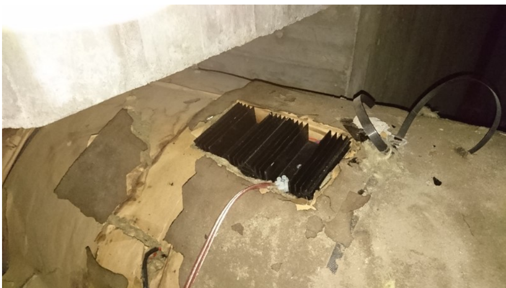
Figur 6: Termoelektrisk generator monterad på en framledning.
