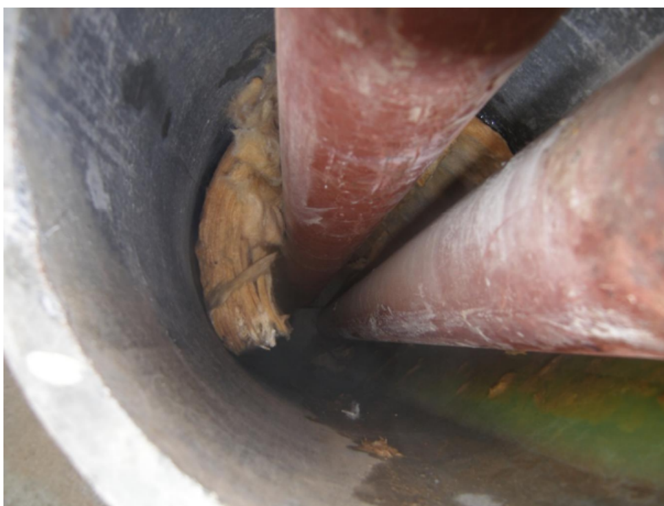
Figur 1: Dränkt eternitkulvert där mycket av isoleringen har sköljts bort.
