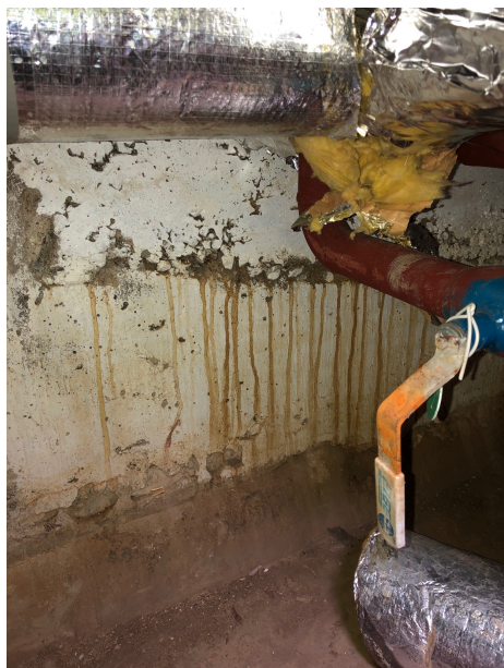
(a) Spricka i kammarväggen.
