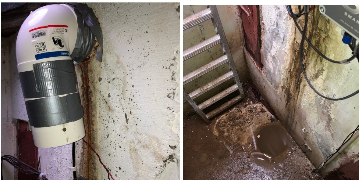
(a) Vatten läcker in genom ventilationsrör.
