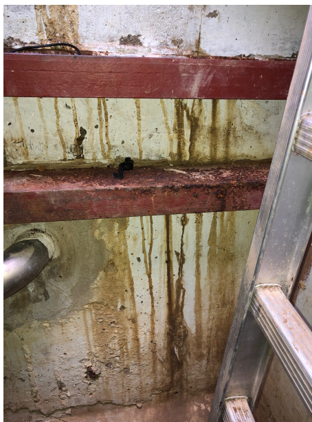
(b) Inläckage från betäckningen.
