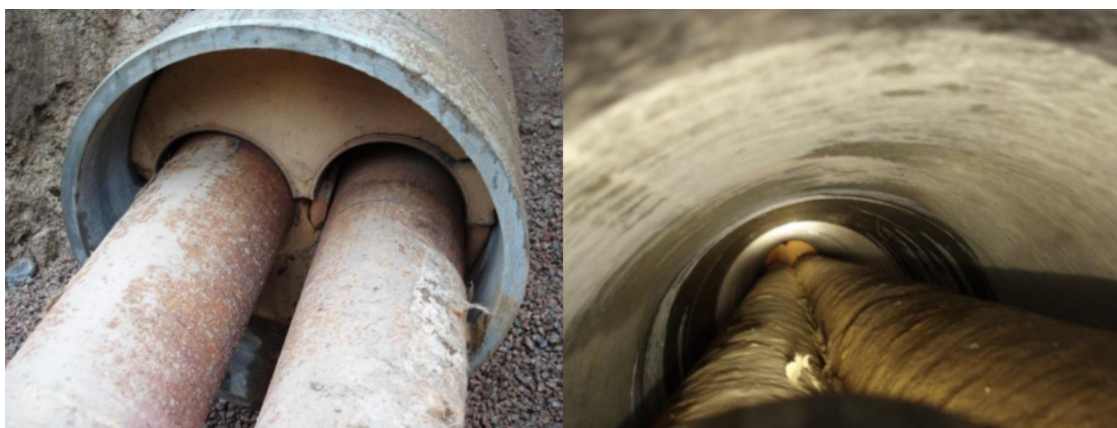
Figur 4: Eternitkulvert med polyuretanstöd.
