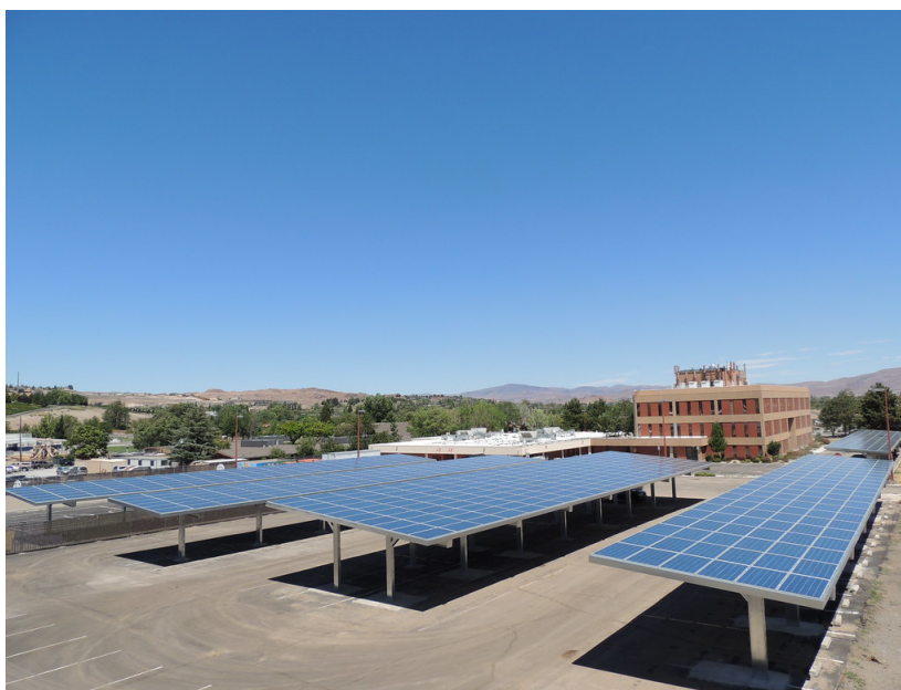
Figur 23: Visar en lösning där parkeringsplatser med carports har solceller på taket. (Solar, CC BY 2.0)
