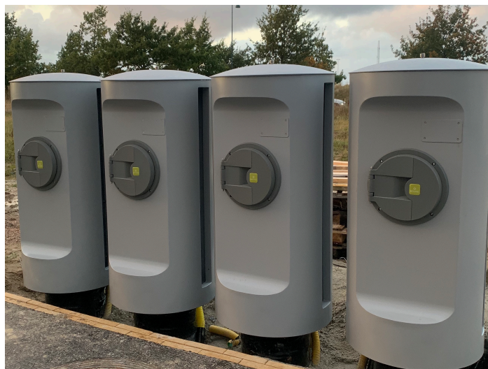
Figur 4. Bild på nyinstallerade sopsugsinkasten på Soluppgången i Brunnsnög (egen bild).
