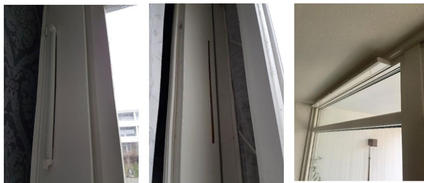
Figur 7. Bilder från efter renovering – skåra i ventilationsluckor och ventil ovan balkongdörr (Magnusson & Sellin, 2018).
