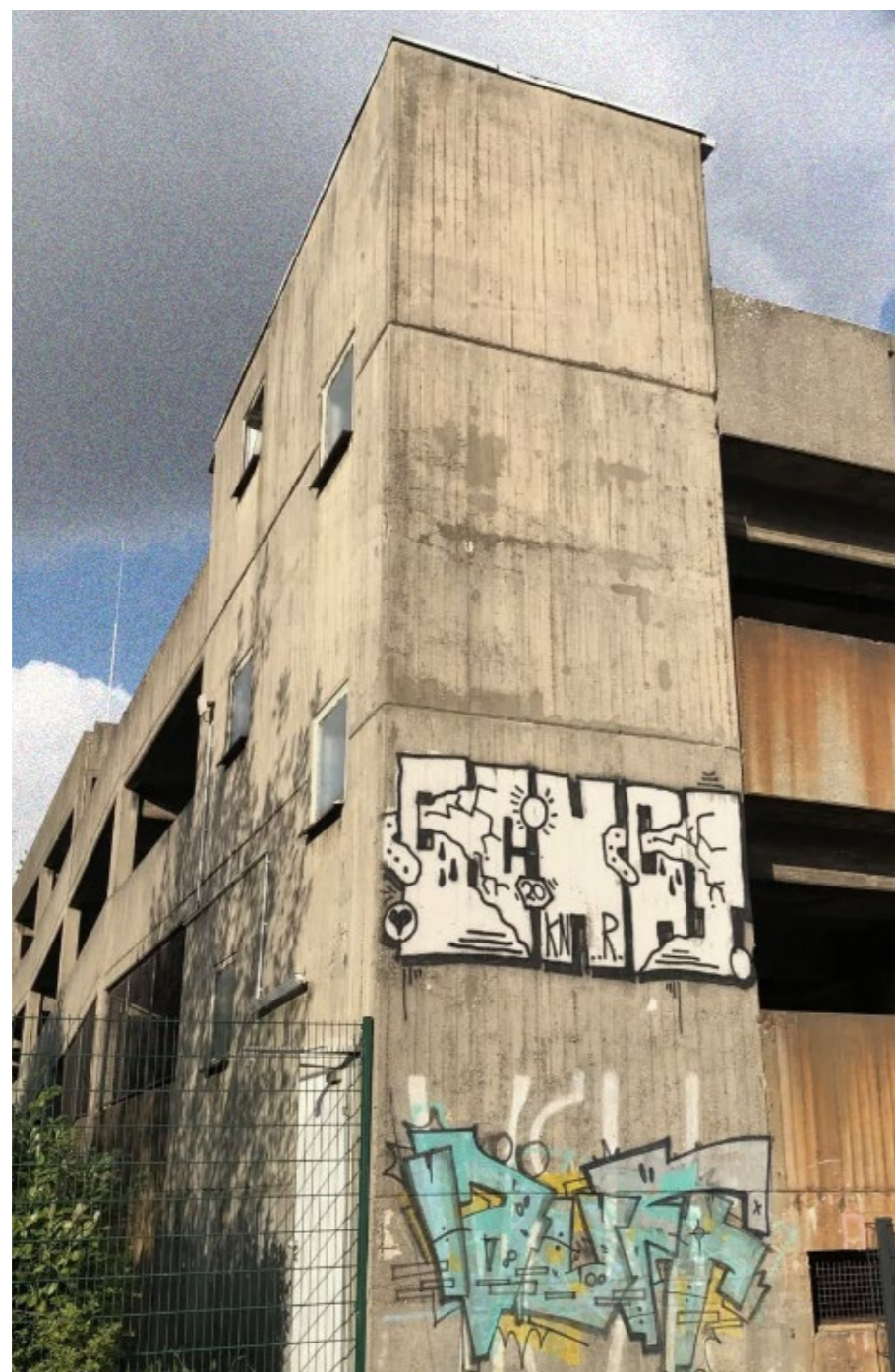
Trapphuset på byggnadens södra sida. På flera ställen på byggnadens fasad finns graffiti av varierande kvalitet.
