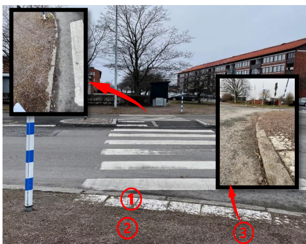
Figur 12: Visar utformningsbrister för det oövervakade övergångsstället Rååvägen 118.
