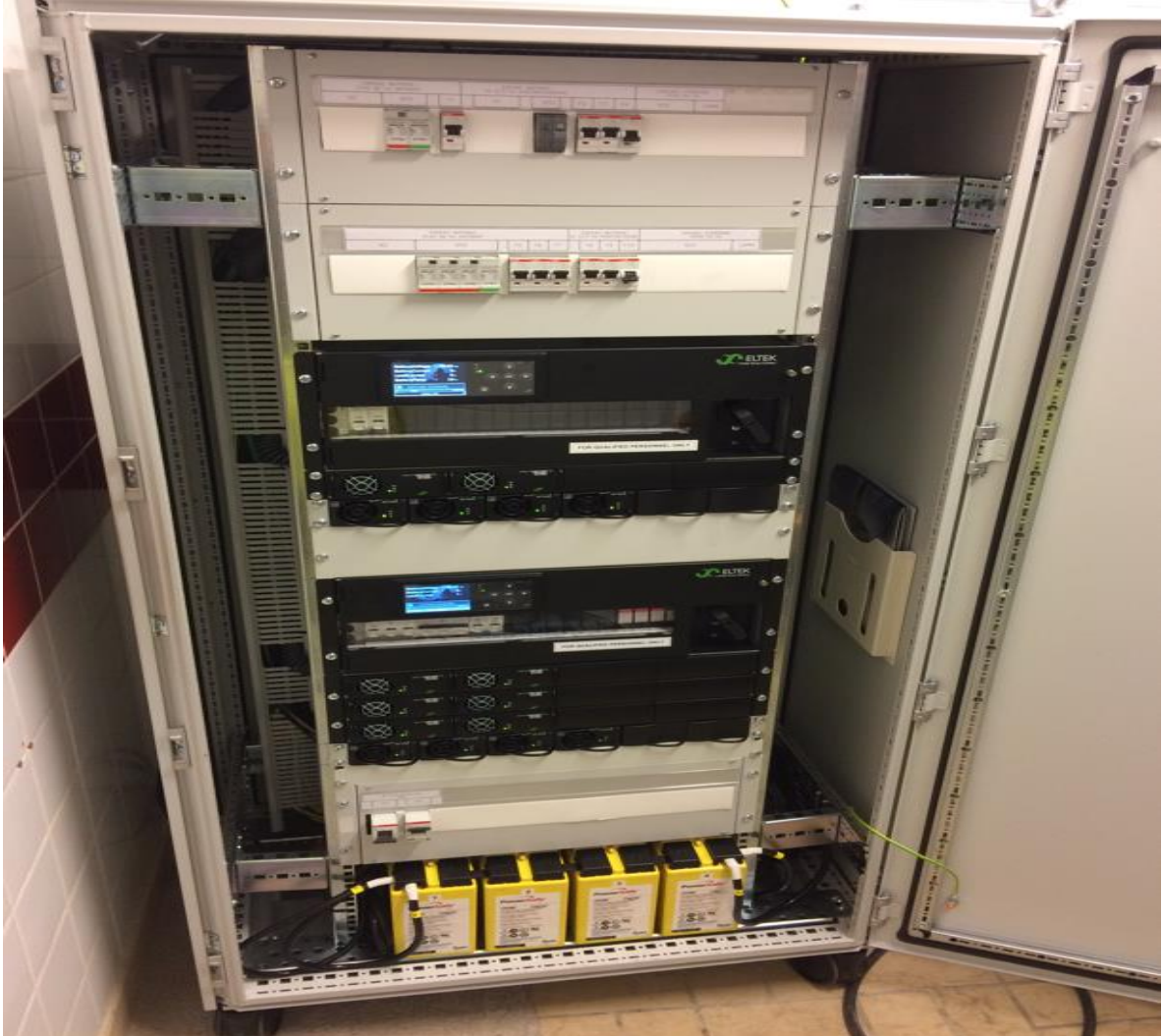
Figur 11, Ett skåp med Rectiverter moduler och ackumulatörer.
