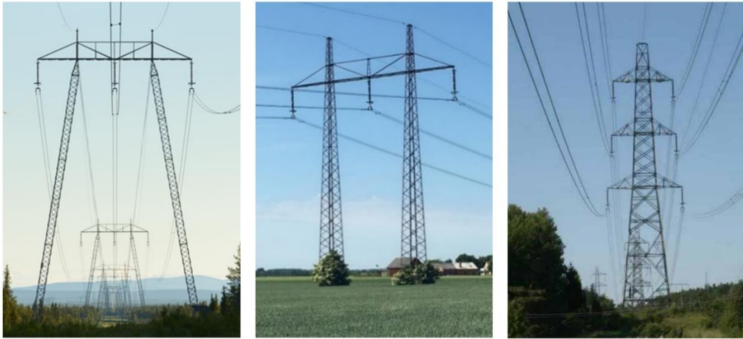
Figur 5. Till vänster en stadgad A-stolpe och i mitten en ostadgad B-stolpe, de vanligaste stolparna i transmissionsnätet. Till höger en julgransstolpe som används när linorna placeras vertikalt (Svenska kraftnät, 2021e; Svenska kraftnät, 2019).
