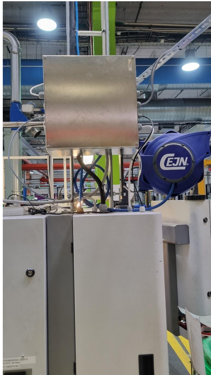
Figur 19 Kopplingskåp monterat på maskinen
