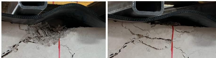
Figur 6.2: Krossad betong vid punktlasten
