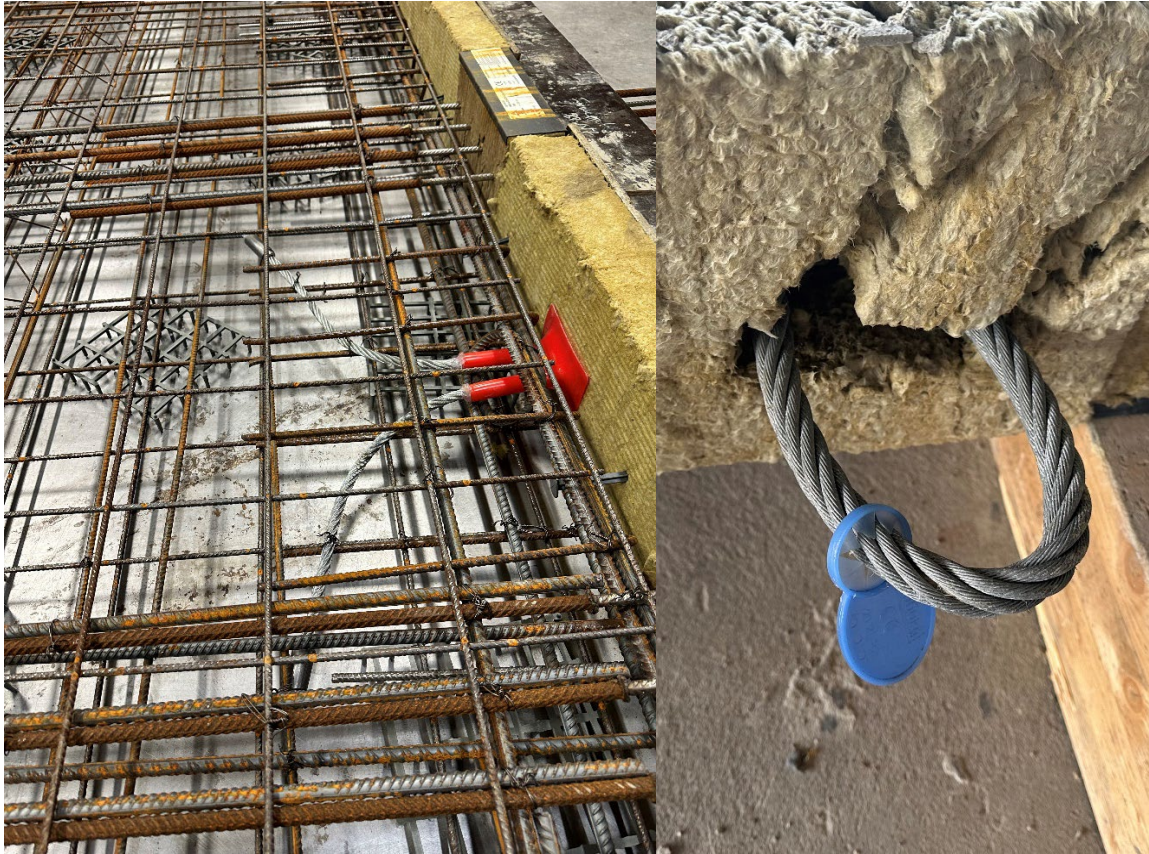
Figur 3. Transportlyft på isolerad sida. Detta består av en vajer som placeras så att ena änden sticker ut genom isoleringen.
