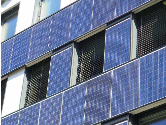
Bild 3. Solcells Installation på fasad ( RISE, 2019)
