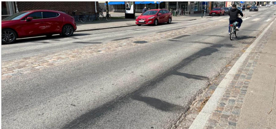
Figur 30. Sträckan på Linnégatan med spårbildning och sprickor som har lagats.
