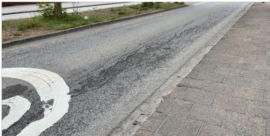
Figur 28. Vid det smala partiet på Södra Bulltoftavägen observerades spårbildning, krackelering och sprickor.
