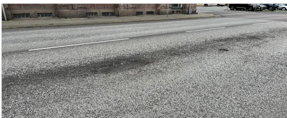
Figur 23. Lokal stensläpp och slaghål av allvarlig karaktär på Norra Vallgatan
