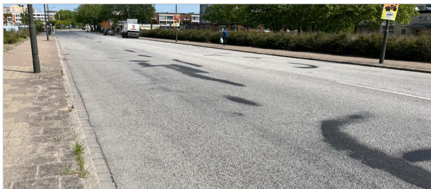
Figur 21. Eriksfältsgatans breda körfält och skador på asfaltbeläggningen som har lappats och lagats.
