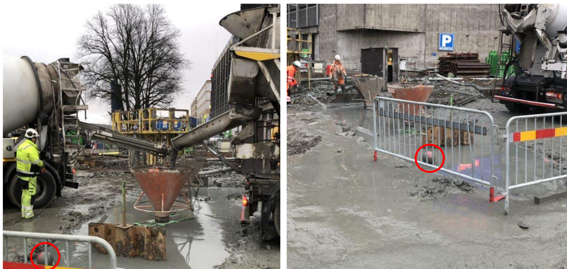
Figur 58 - T.v. pågående gjutning av tvärvägg, boll markerad i vänster hörn. T.h. färdigdjuten panel, boll markerad i mitten
