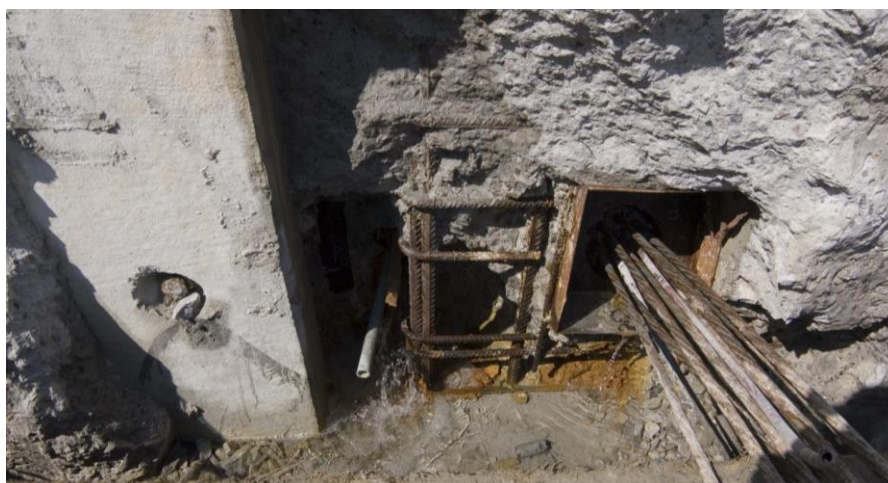
Figur 82 - Fotografi av skadorna från makadaminträngningen. Åtgärden blev borttagning och rensning av inträngd makadam, sedan betonglagning för att erhålla fullgod kvalitet och täckning av armeringen (Fotografi: Per Lindh 2006)
