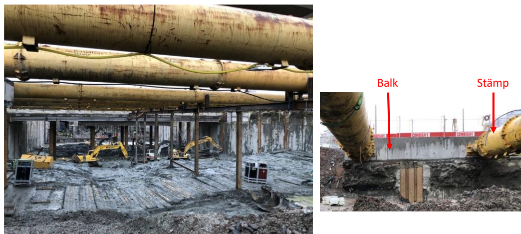
Figur 63 - Hur den kontinuerliga balken ser ut från andra sidan, två olika vyer. T.h. notera stämplet mot balken
