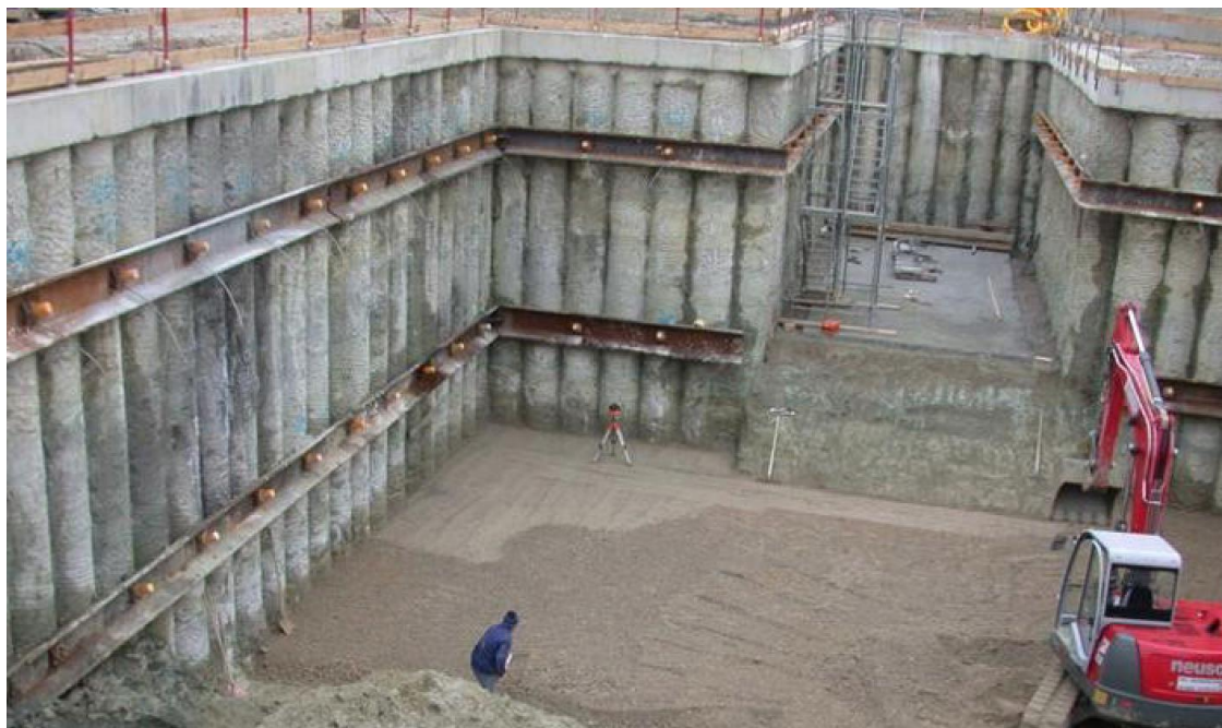
Figur 4 - Exempel på hur en sekantpålevägg kan se ut (Fotografi: Christian Scholz u.å.)
