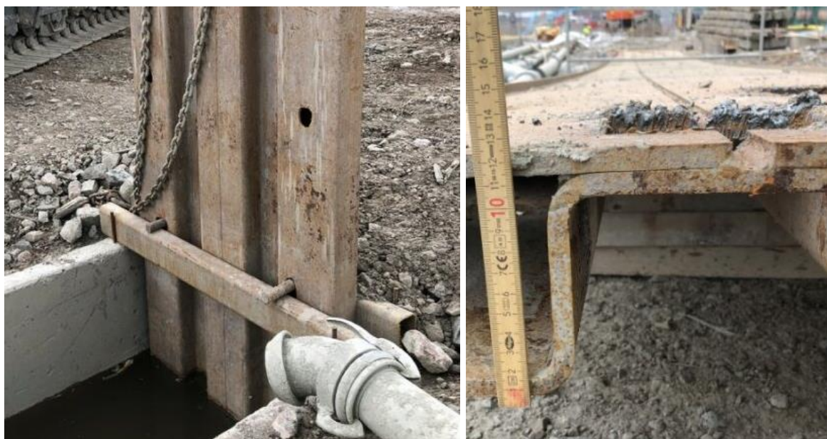
Figur 45 – Exempel på ett stoppelement av stål. T.v. helhetsbild av stoppelementet. T.h. Närbild på förtagning. Förtagningen är 10 cm djup
