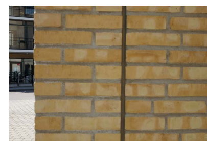
Moderna tegeldetaljer. Dilationsfog - talar inte teglet språk.
