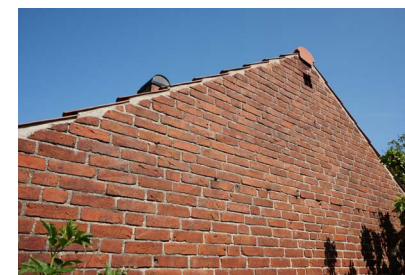
Takavslut. Ett traditionellt möte mellan tak och vägg. Ett knivskarpt avslut som betonar byggnadens volym. .
