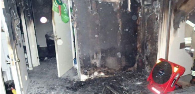
Figur 4-41. Hallen i lägenheten där elsparkcykeln började brinna.
