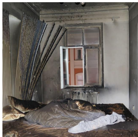
Figur 4-39, Sovrummet i lägenheten där branden startade. Objekten i rummet är brandpåverkade.
