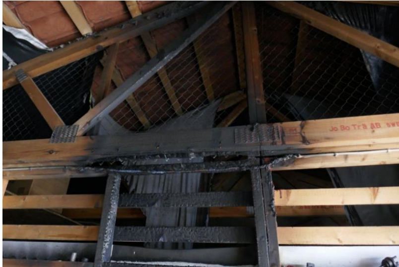
Figur 4-36. Träreglarna bredvid elsparkcykeln som började brinna. Reglarna precis ovanför är brandpåverkade
