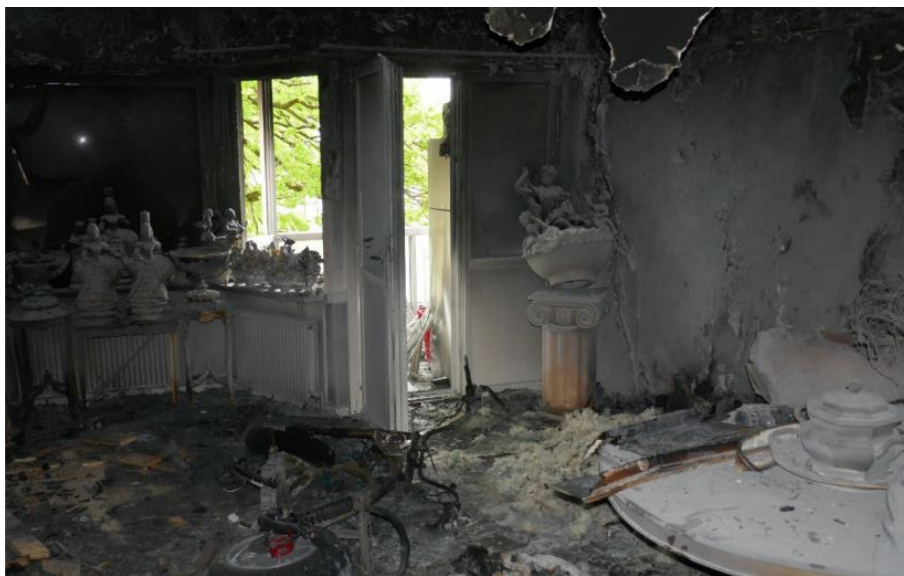
Figur 4-17. Bild från vardagsrummet där branden började. Fatbiken syns ligga på golvet. Hela rummet är brandpåverkat.
