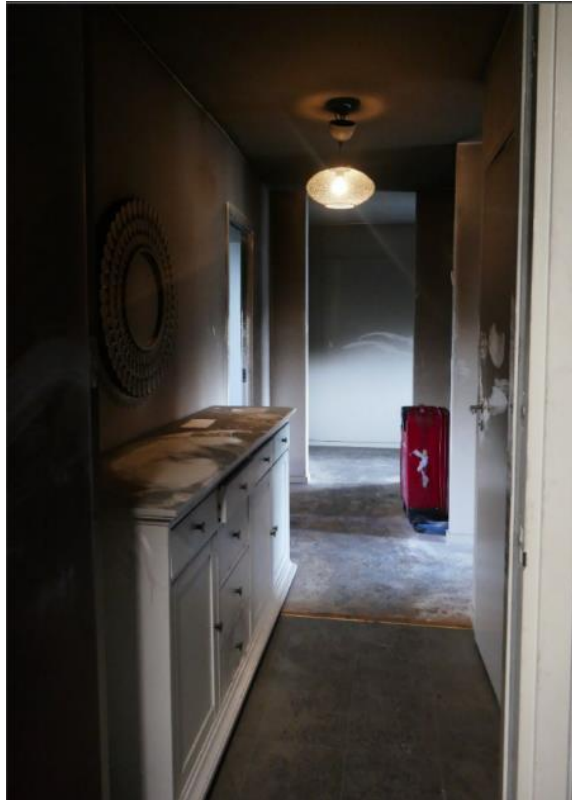
Figur 4-22. Hallen i lägenheten. Rök har spridit sig i den övre delen av rummet
