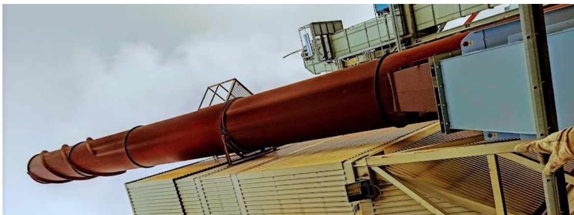
Figur 14: Rökgasledning på asfaltverket i Dalby.
