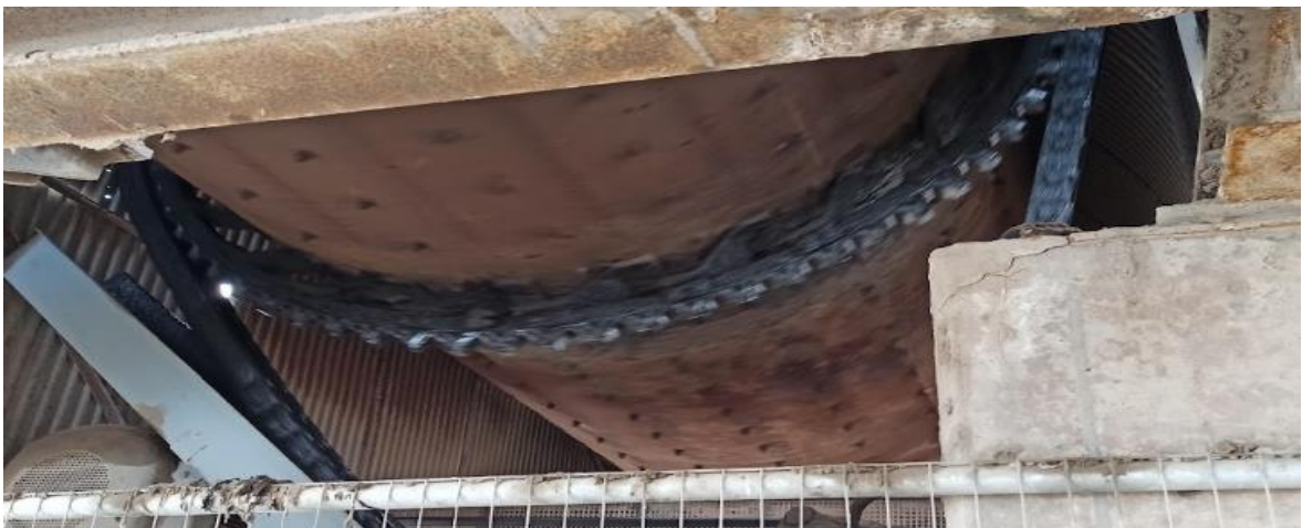
Figur 12: På bilden kan man se torktrumman och drivkedjan på verket i Dalby.
