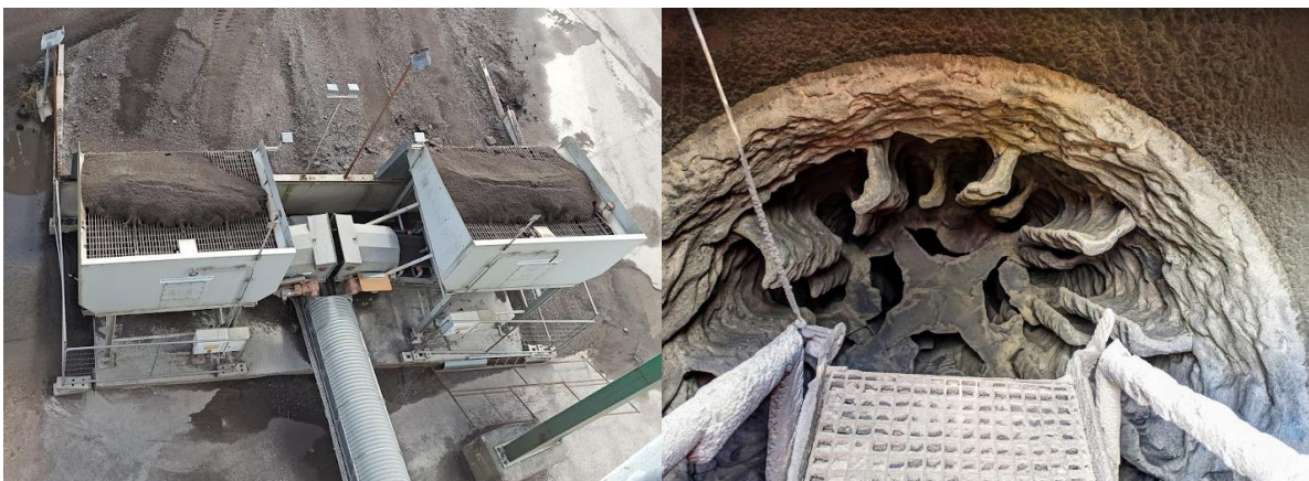
Figur 21: Tillförsel av granulat till parallelltrumman till vänster och insidan av trumman till höger.
