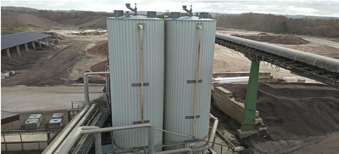
Figur 15: Lagring av bindemedel på asfaltverket i Dalby.
