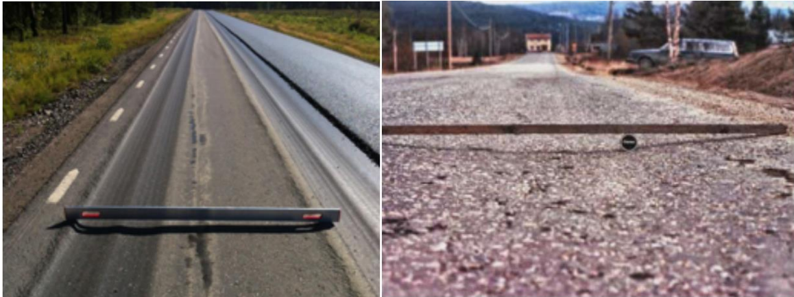
Figur 18: Visar spårbildning som sker på grund av tyngre trafik, vänster bild, och bärighetsberoende spårbildning i höger bild.
