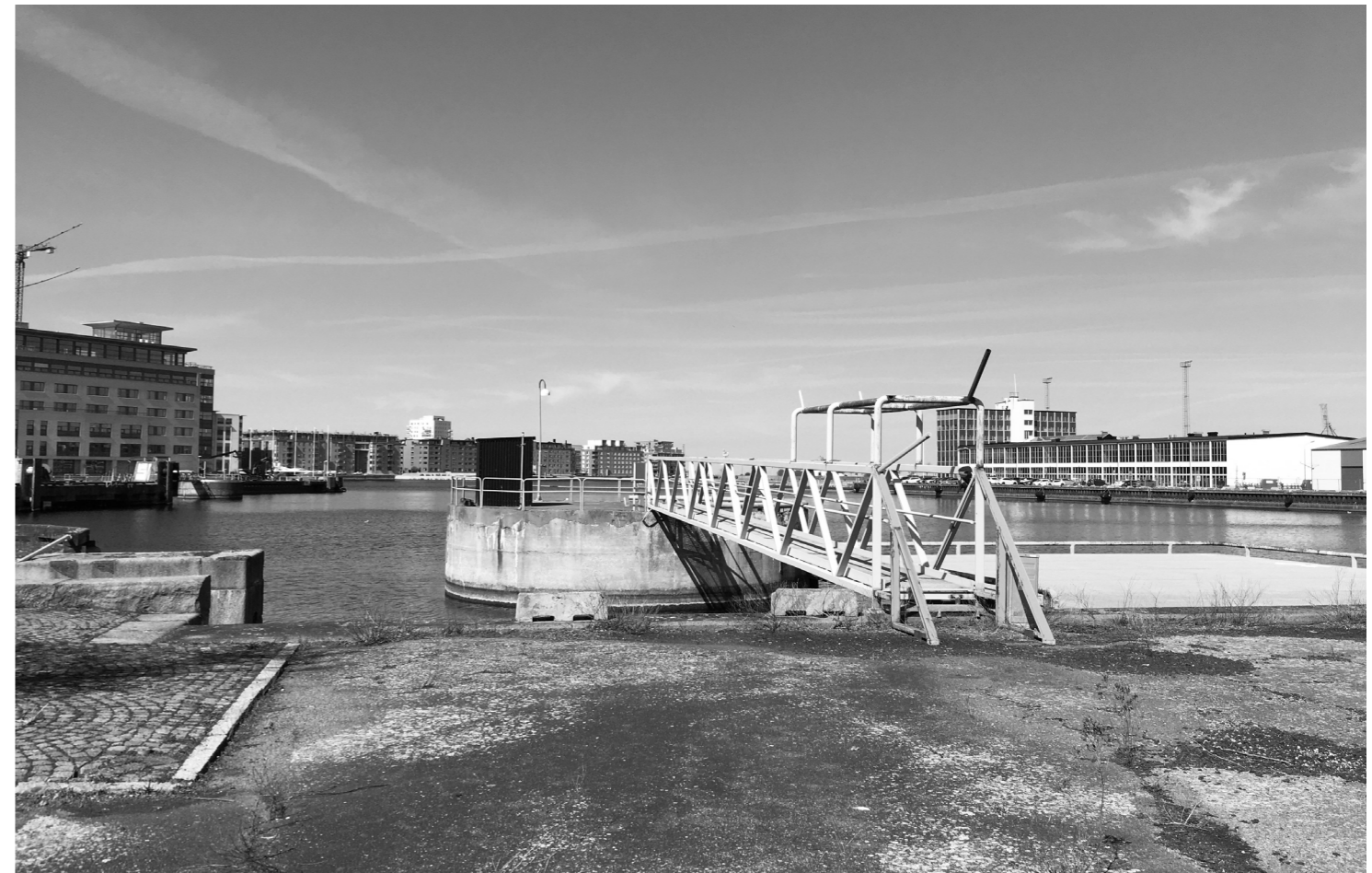
Krackelerad fundament ger plats åt växtlighet
