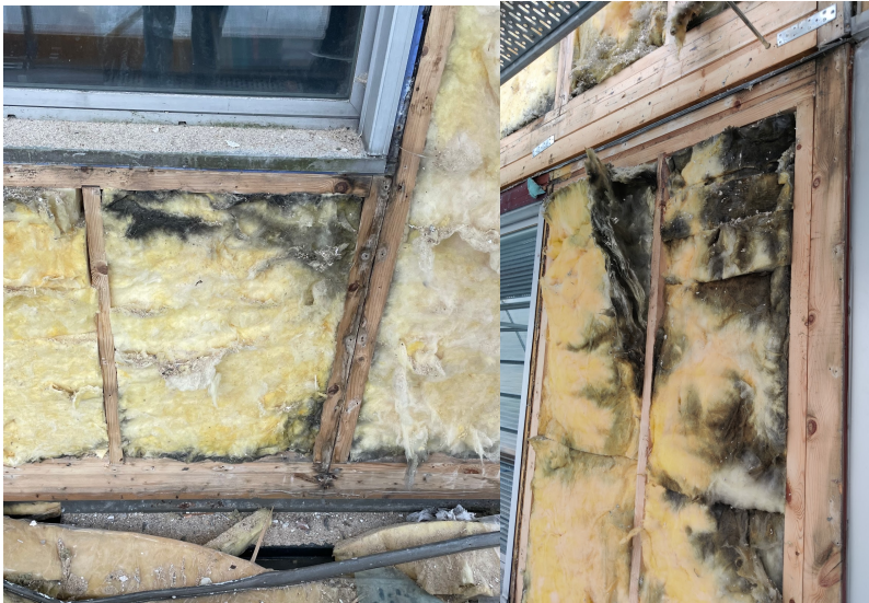
Figur 3.6 Mögelskadade befintliga utfackningsväggar runt fönster
