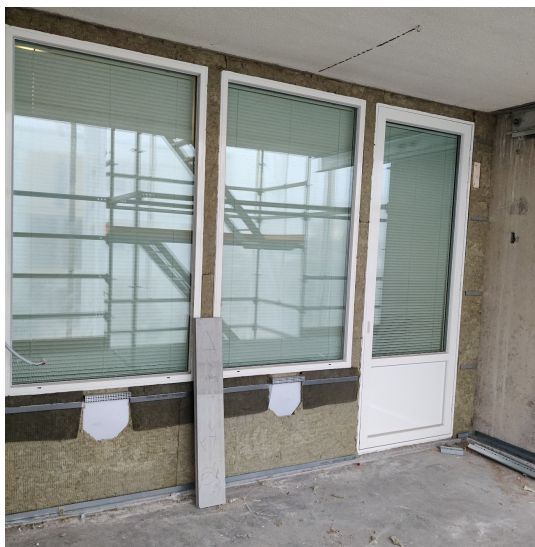
Figur 3.18 Bild på de nya fönsterna och balkongdörrarna som sattes in i samband med renoveringen.
