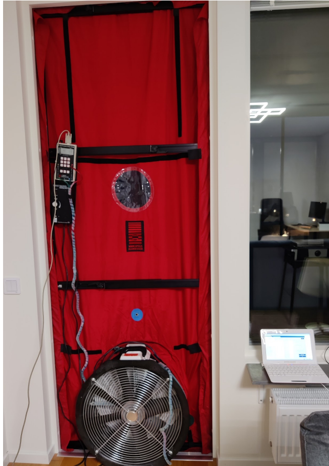
Figur 4.2 Uppställning av Minneapolis Blower Door 4 ihopkopplad med DG-700 Pressure & Flow Gauge och fläktkontrolldosa inför en mätning. Visar även datorn som användes . I detta fallet gjordes uppställning på en renoverad lägenhet där Blower Door satt i öppningen vid balkongdörren. Uppställningen är från lägenhet 1 men tillämpades på samtliga lägenheter.
