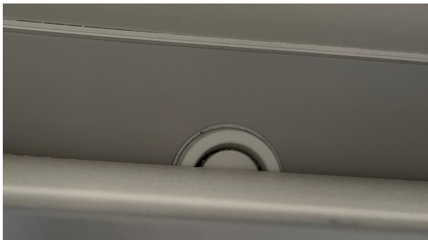
Figur 4.5. Foto på frånluftsdonet som inte kunde tätas då det var placerat bakom en fastskruvad möbel.
