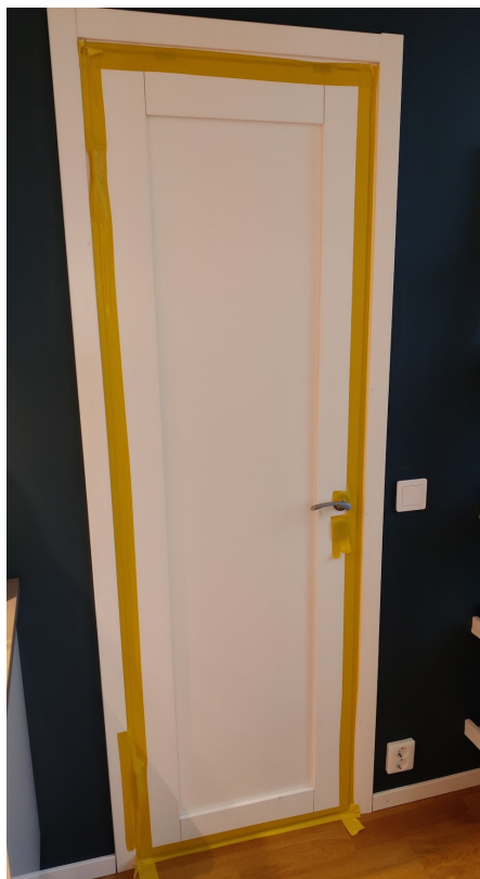
Figur 4.6. Dörr i innvägg som avdelar köket mot sovrummet (med frånluftsdonet som inte gick att tätas) för lägenhet 1.
