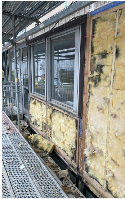
Figur 3.5 Mögelskadade befintliga utfackningsväggar efter att fasadskivor tagits av.
