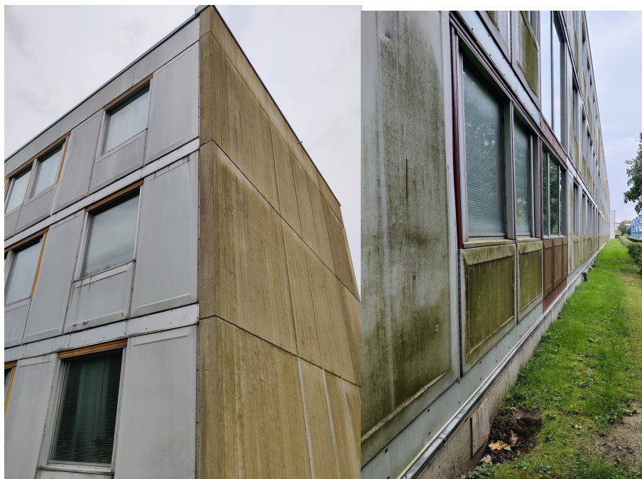
Figur 3.11 Bilden visar hur husen ser ut innan renovering med originalfönster och fasadskivor, samt gavlarna i platsgjuten betong (till vänster).
