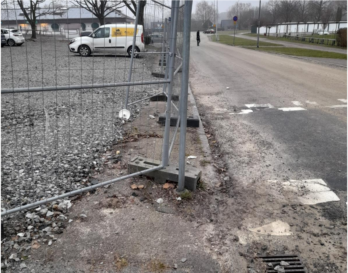
Figur B4: I fotot ses trottoaren mellan övergångsstället och parkeringen som är helt täckt av byggstaket. Bild tagen av Bengtsson 2024.
