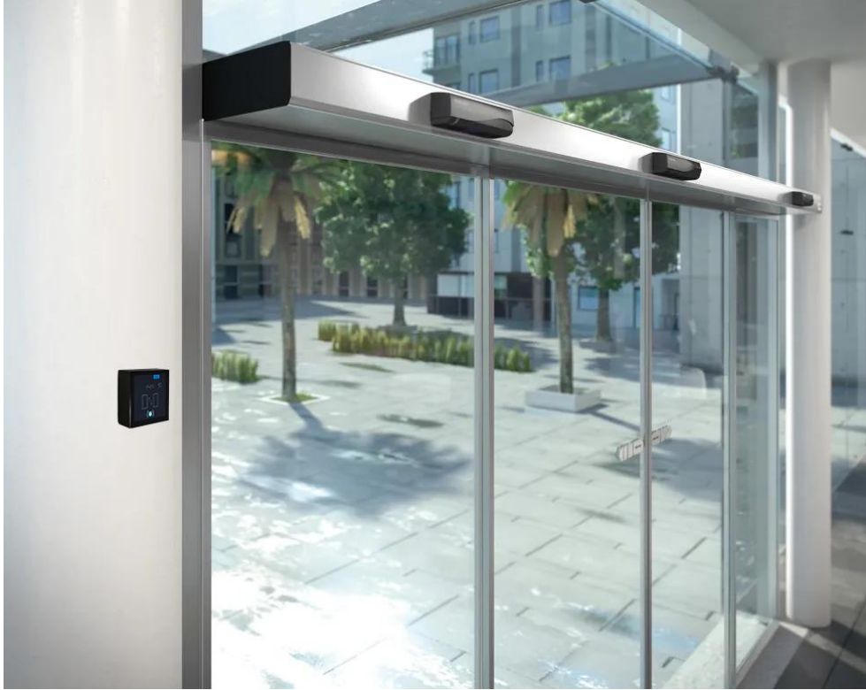
Den digitala programväljaren, pekskärmlösningen, installerad bredvid ett par skjutdörrar.
