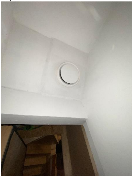
Figur 3.4 – Bild av tilluftsdonet TD1 i luftkammaren. Donet är anslutet till husets ventilationssystem, placerat över dörröppning i luftintagskammaren. Foto: Hellquist Lilja & Sandström.
