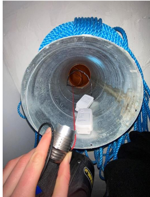
Figur 3.13 - Installation av sensorerna "C" och "D" som placeras i rörmynningen. Foto: Hellquist Lilja & Sandström.
