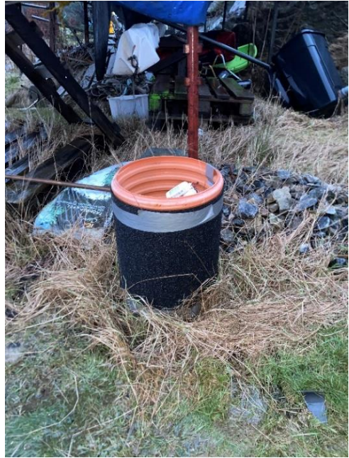
Figur 3.10 – Bild på utvändig vertikal rörmynning av husets EAHE-system. Se figur 3.1 för placering på tomt. Foto: Hellquist Lilja & Sandström.
