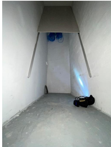
Figur 3.5 – Bild inifrån kammaren. Visar avskiljande vägg mellan inloppsröret och tilluftsdonet TD1. Foto: Hellquist Lilja & Sandström.
