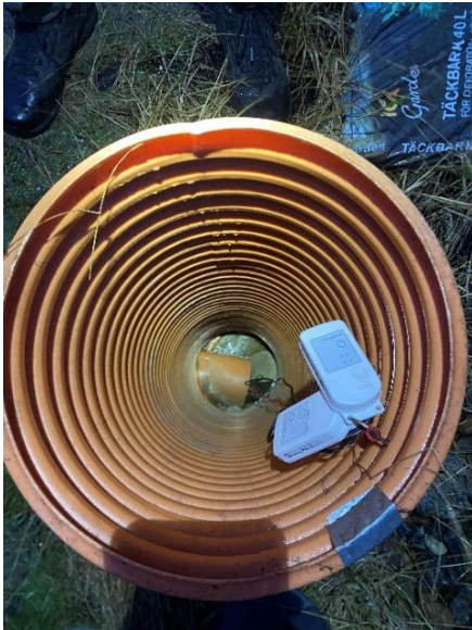
Figur 3.11 - Bild ner i det vertikala utvändiga markröret som leder ner till det horisontella markröret. Visar installation av sensorerna "A" respektive "B". Foto: Hellquist Lilja & Sandström.
