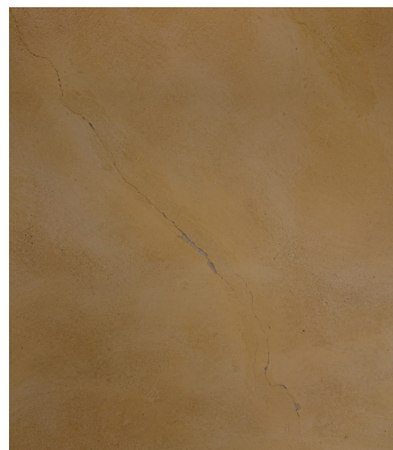
Lagning som spricker på nytt
