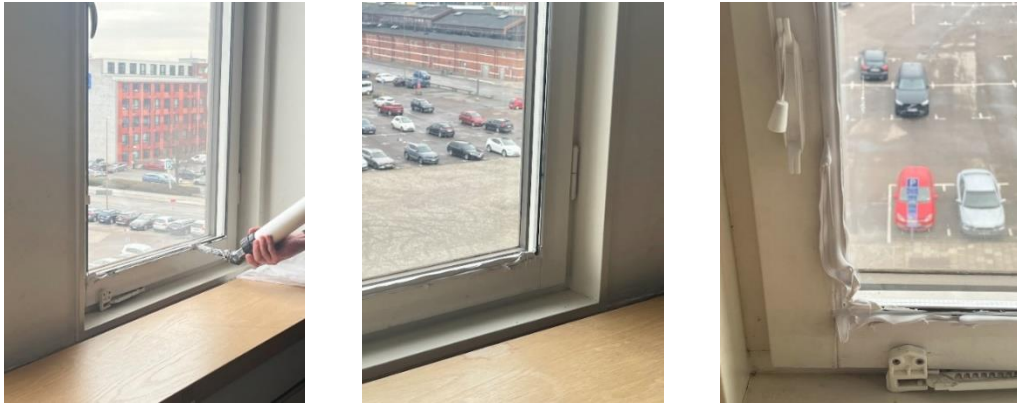
Figur 25. Spill av silikonfogmassa (Foto: Karin Stålhammar live-montage Grundels klimatruta 2024-02-14 i Malmö)
