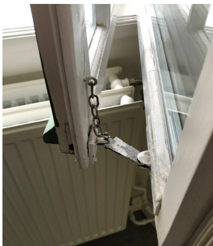
Koppling i fönster som ger skador i ytterbågen.
