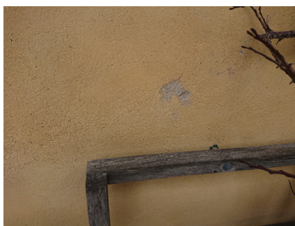
Mekanisk nötning från växtlighet
