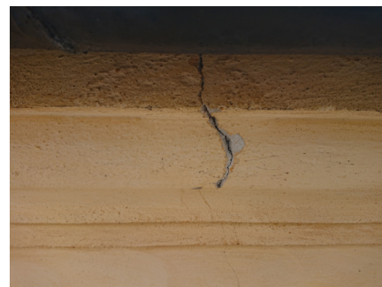
Spricka i takfotsgesims
