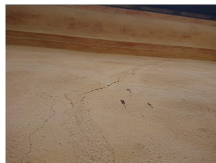
Tidigare lagning av spricka
