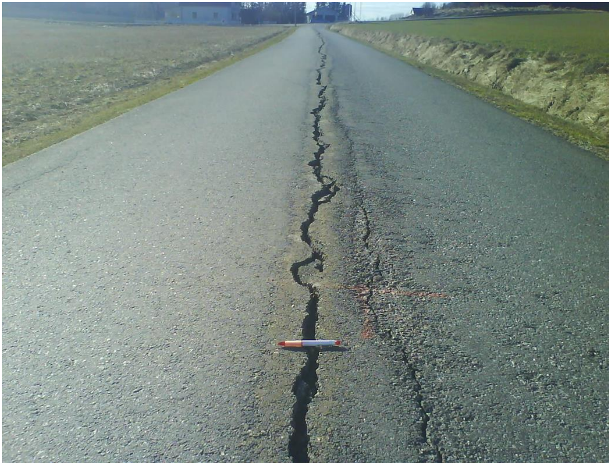
Figur 3. Tjälskador i en vägkonstruktion (Foto: Sven Agardh)
