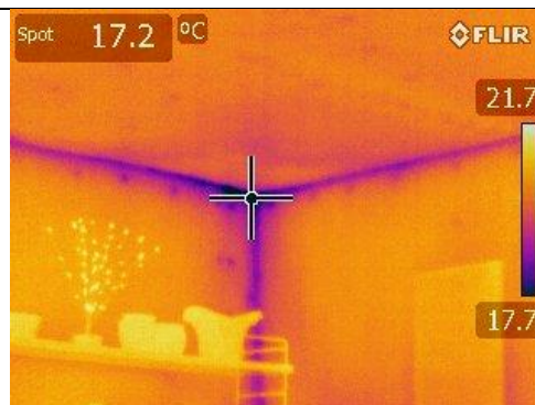
Figur 12. Termografering av hörn i vardagsrum.
