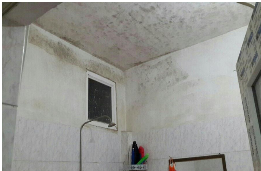
Figur 4.6 Fukt- och mögelproblem i badrum
