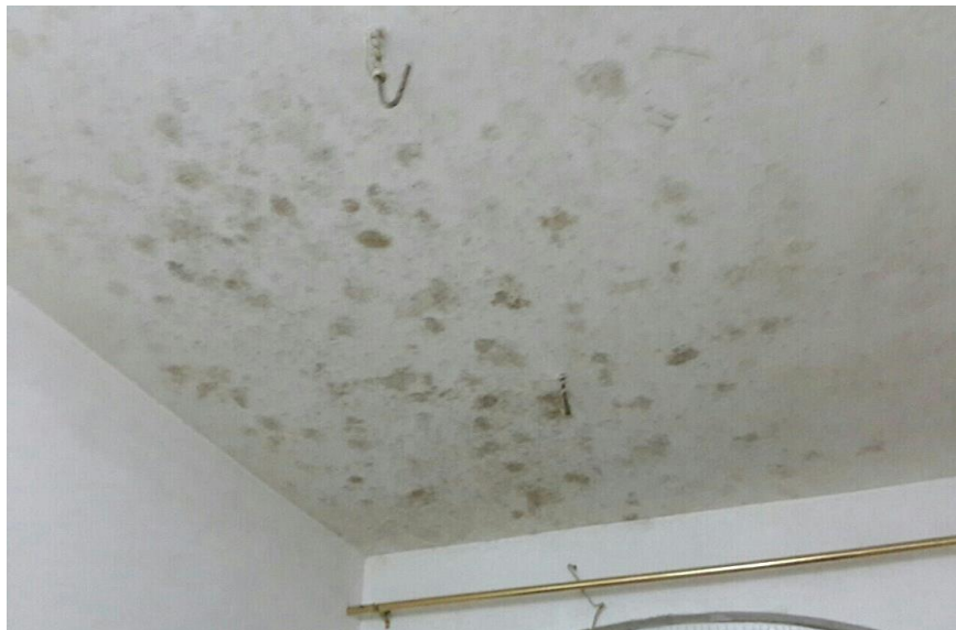
Figur 4.5 Mögel på grund av regnvatten, vattensamling på tak ovan sovrummet och lågt ventilationsflöde
