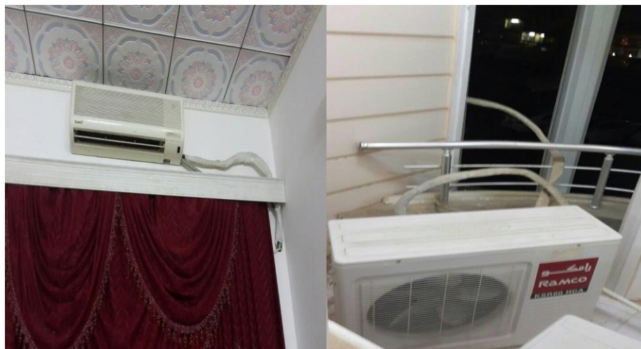
Figur 4.3 Dekorative wall split unit (kyl och värmepump)
