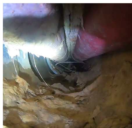
Figur 5: Insidan av en eternitkulvert med dubbelledning där isoleringen skadats och fallit ner.
