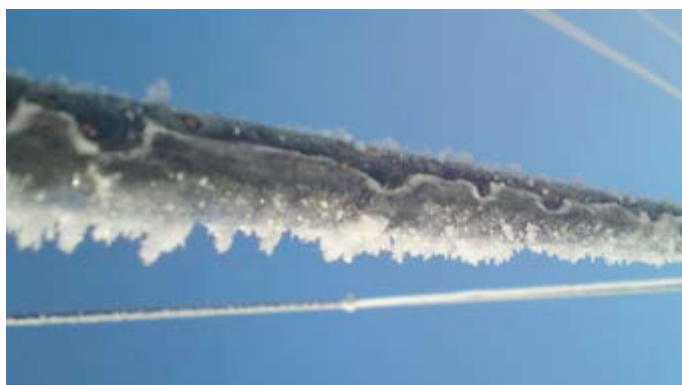
Figur 9: Isbildning på kontaktledning (Foto: Olofsson, A)
