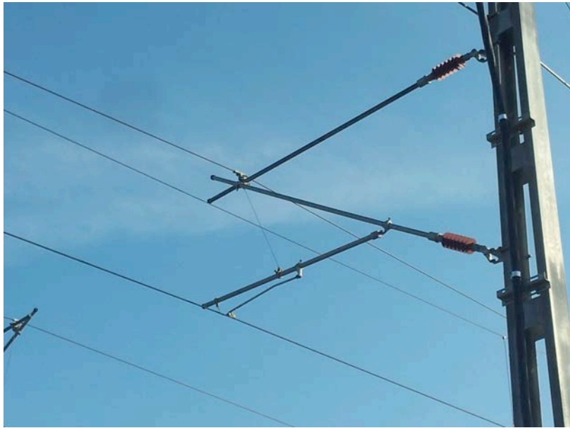
Figur 6: Utliggare system ST (Foto: Nielsen, M. 2013)
