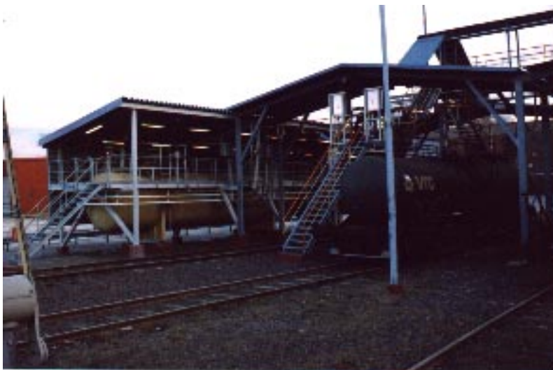
Bild 6.1. Lagrings- och lossningsplats för svaveldioxid.
