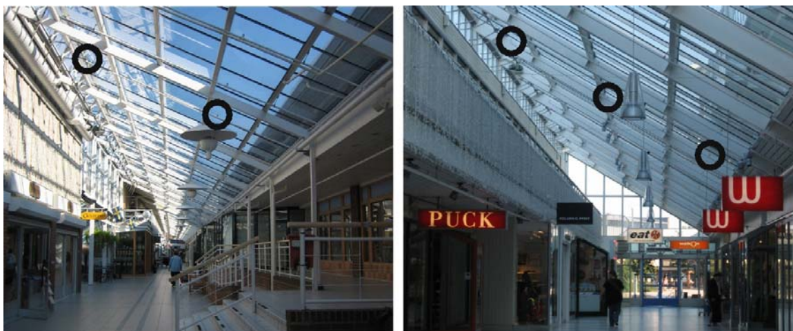
Figur 2.4 Sprinklerhuvuds placering i gatans södra respektive norra del markeras med ring.
