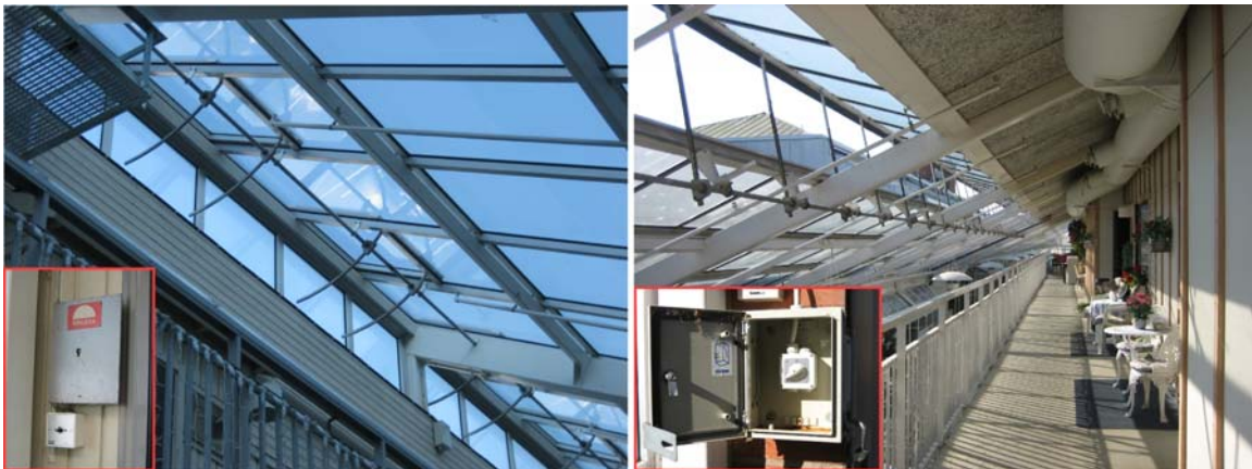
Figur 2.5 Manuellt öppningsbara luckor med manöverskåp.
