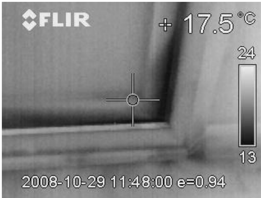
Bild 17 visar hur luft läcker in där balkongdörren ansluter till dörrkarmen.
