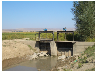
Exempel på en kanal i ett bevattnings-nätverk. Här styrs flödet manuellt. 1
