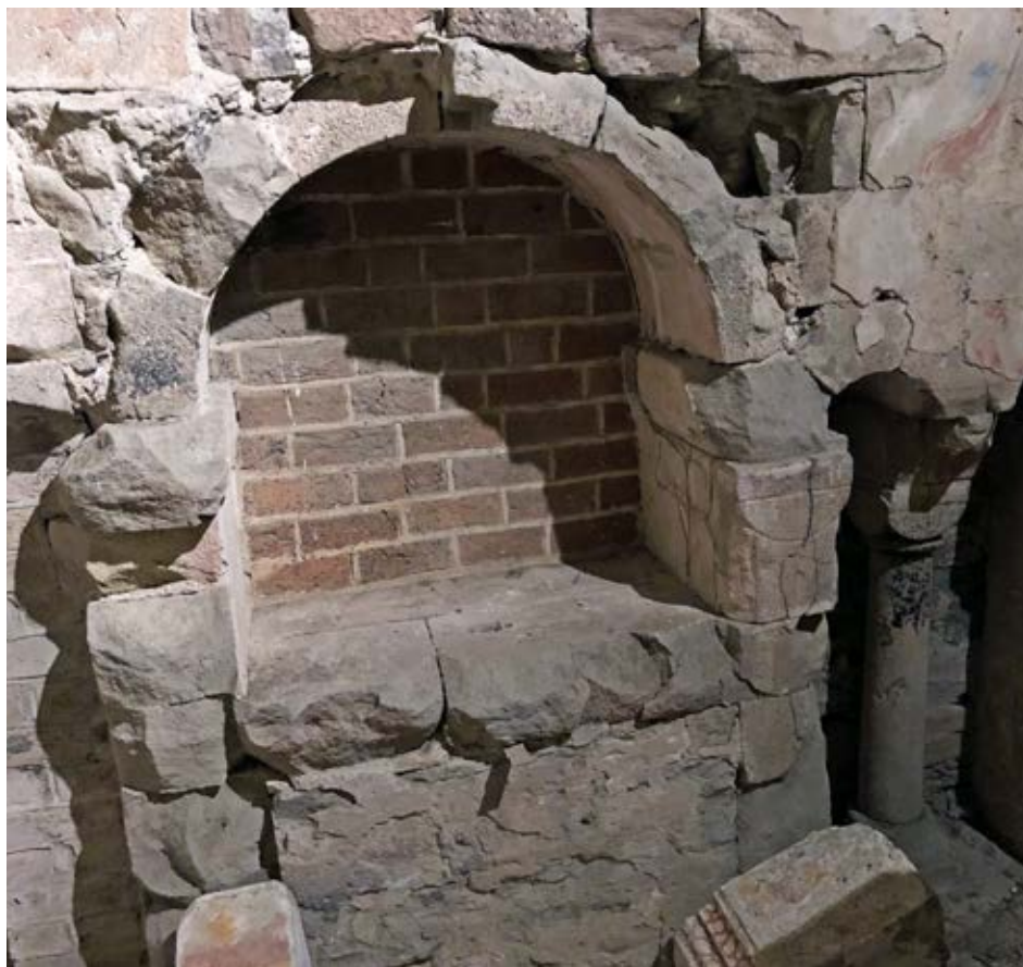
Fig. 15. Ett exempel på rejäla brandskador finns i tornets empor-kapell. Skadorna kan härröra från en förmodad brand 1318. Emporen verkar inte ha drabbats så hårt av branden 1213, då inga långhusvalv fanns som kunde leda in elden i kapellet. På bilden syns empor-altaret med relikgömma. I samband med långhusvälvningen avskärmades altaret med en tegelmur mot långhuset.
