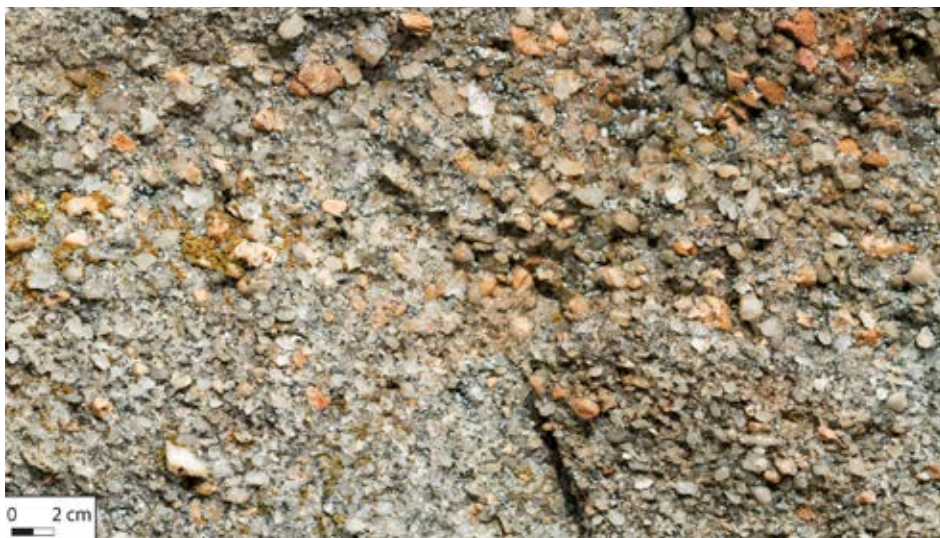
Fig. 8. Kvarnstens-kvaliteten av sandsten, som kyrkan i Vä till stor del är byggd av, kan innehålla stora gruskorn och små stenar. Dessutom finns lera inlagrad i stenen, vilket gör att den vittrar Foto: Anders Ödman.
