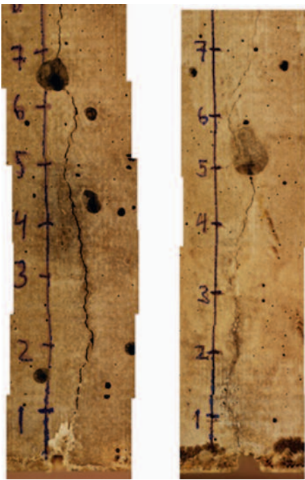
Figur 8: Exempel på spricka efter ett års nedsänkning i havsvatten.
