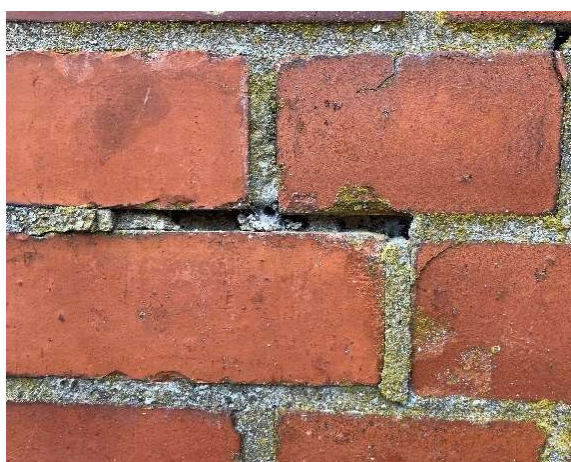
Figur 2.1 Skadat fogbruk i nygotisk kyrka.
