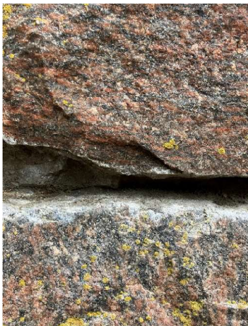
Figur 3.5 Sandigt murbruk bakom fog, augusti 2022.
