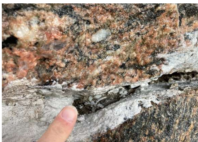
Figur 2.2 Djup fog med sandande murbruk i naturstensmurverk under renoveringsarbete.
