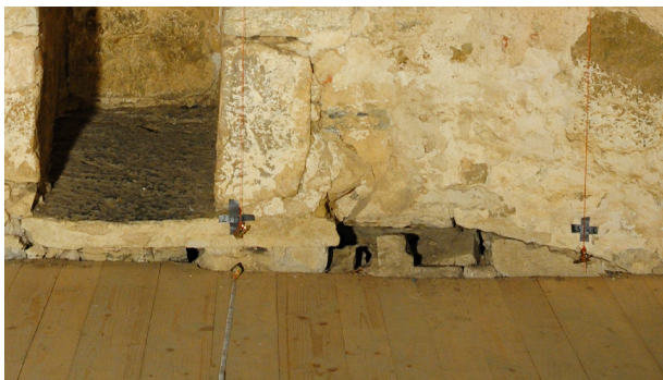
Fig. 15 i hela rum 2 löper en skada i golvnivå. Detaljfoto från södra väggen, se ritning 2S3. Foto: Tina Westergren, 2011.
