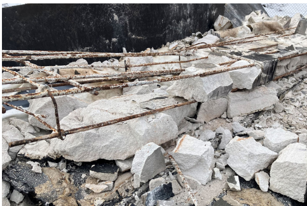
Figur 8. Foto från rivningsarbetet. Visuella tecken på korrosion genomgående på armeringen.
