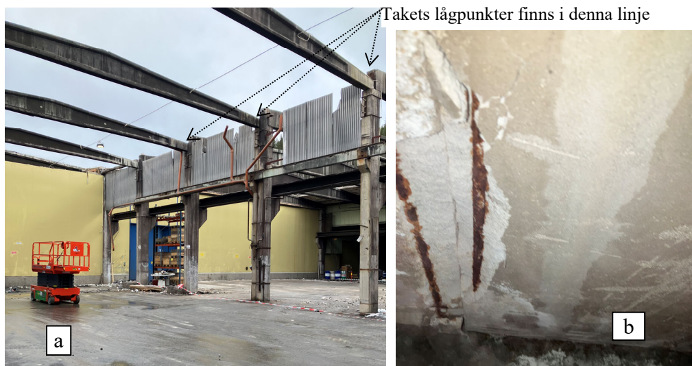
Figur 4. Industribyggnad från 1958. a) Efter nedmontering av takelementen. b) Exempel på skador före nedmontering.
