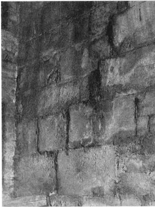
Fig. 47. Skarv efter äldre genombrytning av transeptmuren synlig från vinden över södra sakristian.
