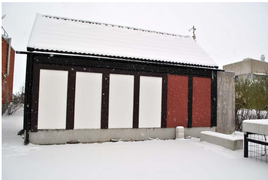
FOTO 1. Provväggarna från utsidan (de vita facken).
